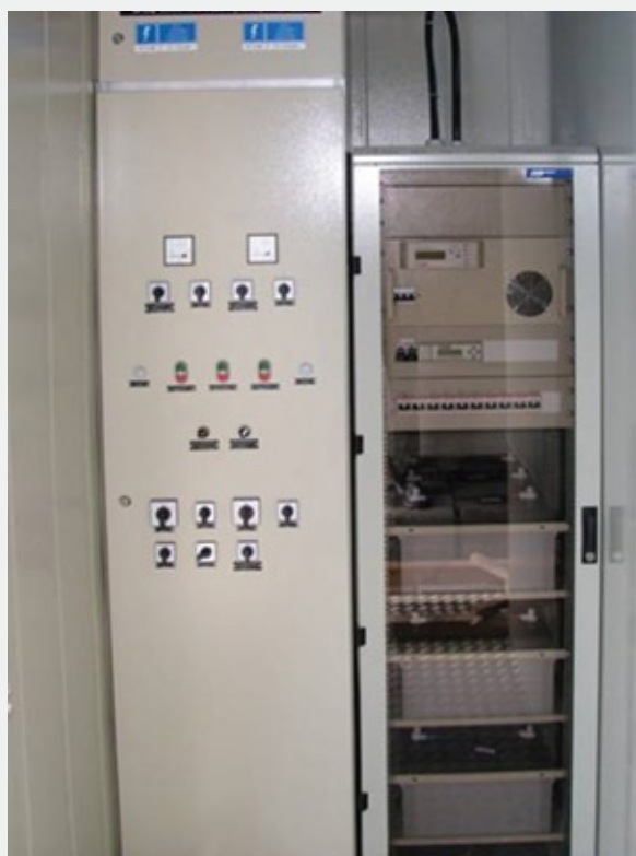
Рис. 53. Распределительное устройство собственных нужд (РУСН) напряжением 0,4 кВ (слева); шкаф оперативного тока (ШОТ) с комплектом аккумуляторных батарей (справа)
