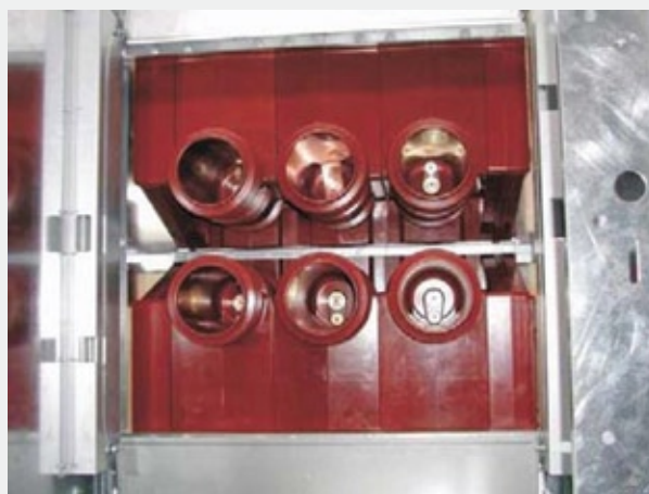
Рис. 29. Отсек выкатного элемента
