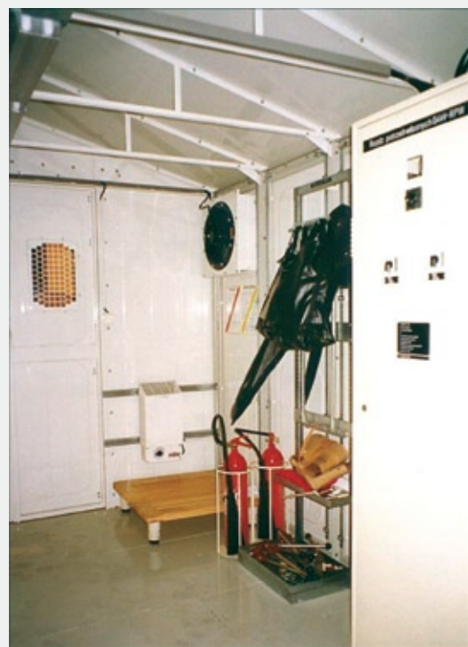
Рис. 61. Стойка средств защиты с установленными защитными средствами
