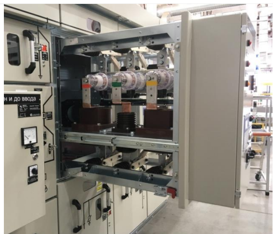
Рис.1.5 Положение технического обслуживания моноблока
