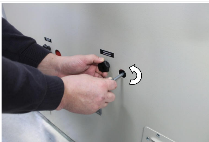
Рис. 2.21 Отверстие аварийного отключения силового выключателя
