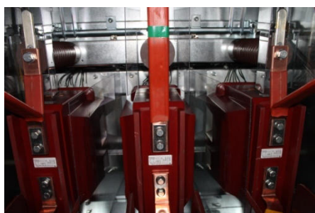
Рис.1.6 Отсек присоединений НССШ
