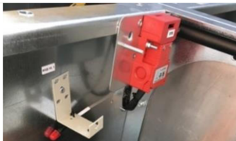
Рис. 1.27 Комбинированная защита от дуговых замыканий (клапанная и волоконно-оптическая) в отсеке сборных шин
