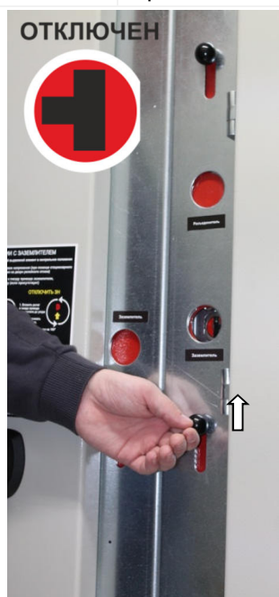
Рис. 2.14 Гнездо привода заземлителя СШ, заземлитель СШ отключен
