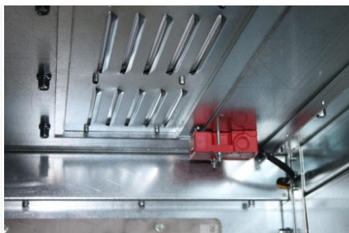
Рис. 1.21 Концевой выключатель в отсеке сборных шин ВССШ
