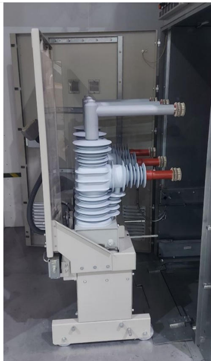
Рис.1.17 ВЭ в ремонтном (сервисном) положении
