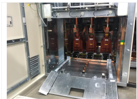
Рис.1.7 Отсек присоединений ВССШ
