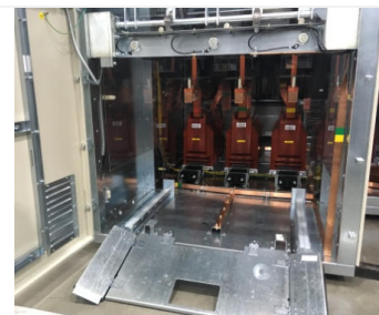
Рис. 7 Отсек присоединений ВССШ
