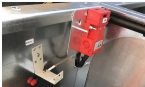
Рис. 19 Комбинированная защита от дуговых замыканий (клапанная и волоконно-оптическая) в отсеке сборных шин
