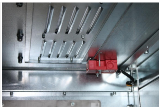
Рис. 13 Концевой выключатель в отсеке сборных шин ВССШ
