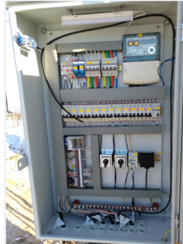
Рис. 3.15. Вид шкафа собственных нужд
