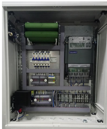
Рис. 3.8. Вид шкафа учета электроэнергии
