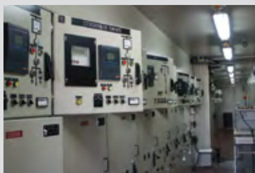
Рис. 6.19. Релейный отсек (вид с фасада)
