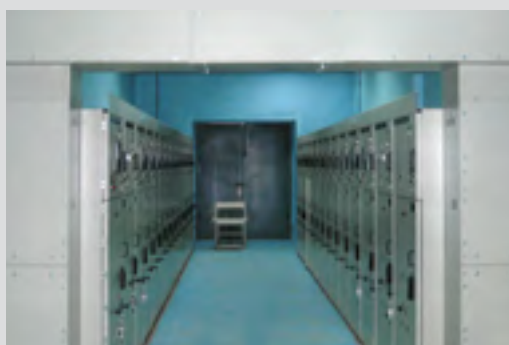
Рис. 11.3. Двухрядное расположение шкафов КРУ
