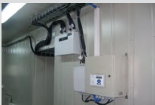
Рис. 10.7. Размещение логического устройства в отдельном шкафу
