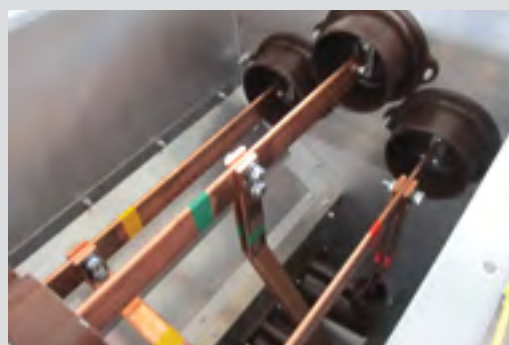
Рис. 6.4. Отсек сборных шин (вид при демонтированном клапане сброса избыточного давления)
