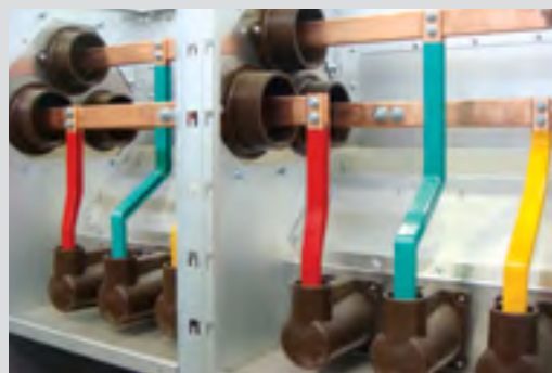
Рис. 6.3. Отсек сборных шин на этапе сборки КРУ
