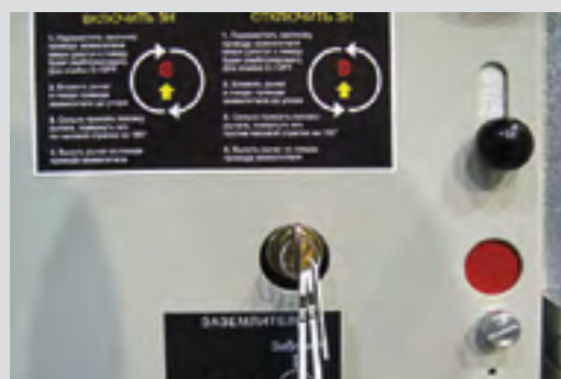
Рис. 9.6. Замковая блокировка заземлителя
