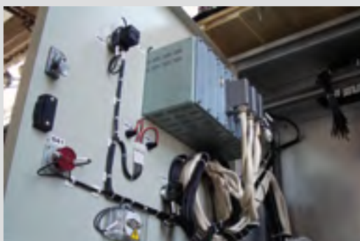
Рис. 10.6. Размещение управляющего терминала на двери отсека
