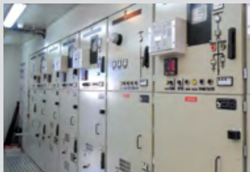
Рис. 1.2. РУ на базе шкафов КРУ D-12PT
