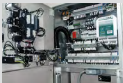
Рис. 6.18. Релейный отсек (вид с открытой дверью)
