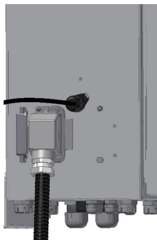
Рис.4.8. Подключение кабеля оперативного питания к шкафу управления
