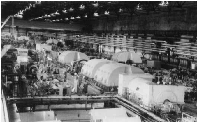
Машинный зал Ленинградской АЭС
