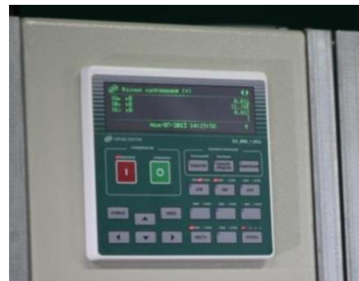
Рис.5.6. Контроль фазных напряжений
