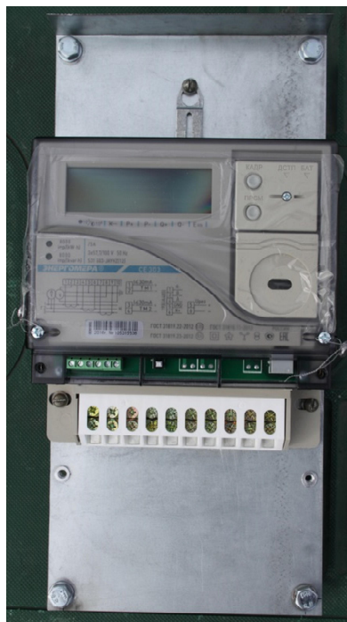
Рис. 4.43. Счетчик электроэнергии, установленный на малой монтажной панели
