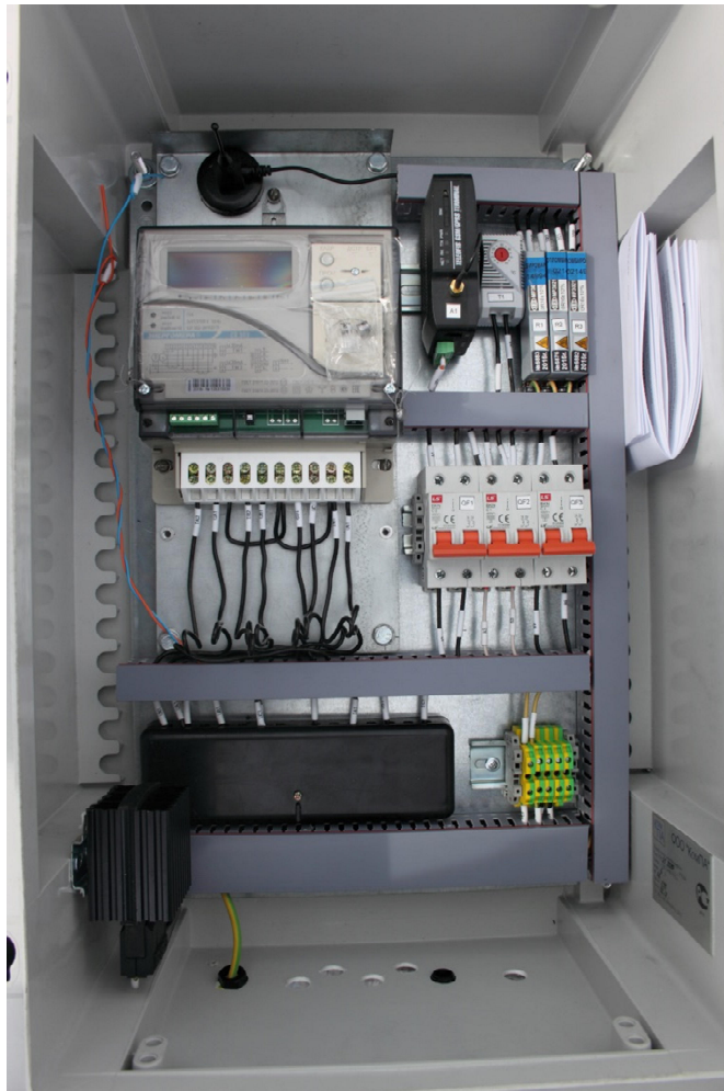
Рис. 4.44. Смонтированный счетчик электроэнергии в шкафу учета
