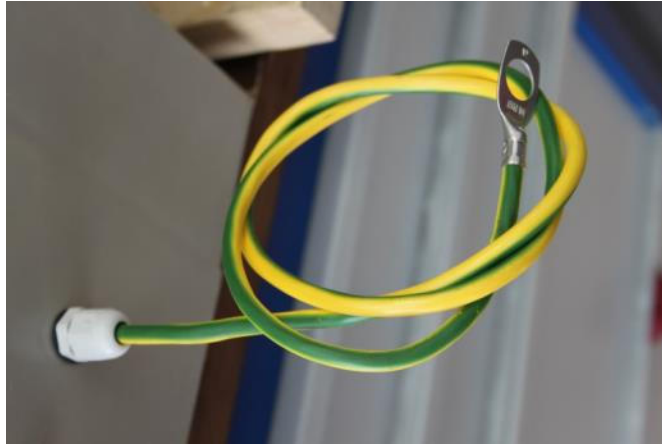
Рис. 4.58. Заземление шкафа учета
