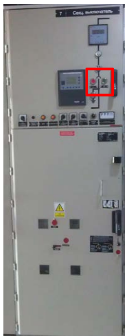
место расположения – фасад КРУ 10(6) кВ
