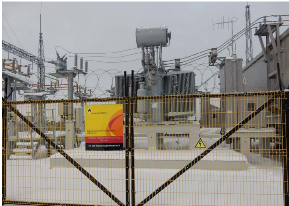
Рис. 1.1. Общий вид подстанции 35/10(6) кВ с ОРУ 35 кВ на реклоузерах SMART35
