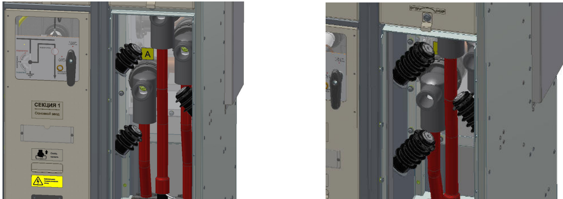
Рис.6.47. Пример установки ОПН 6 кВ (слева) и 10 кВ (справа) в шкафу ШС
