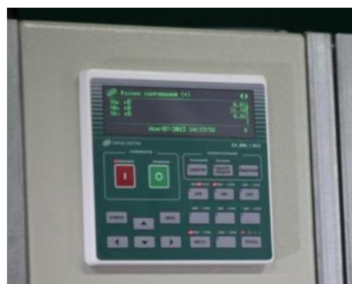
Рис.5.6. Контроль фазных напряжений
