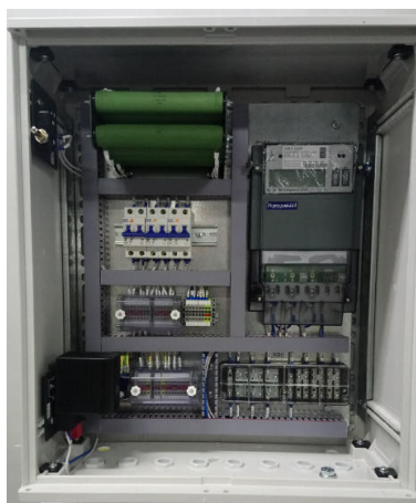
Рис. 6.8. Вид шкафа учета электроэнергии
