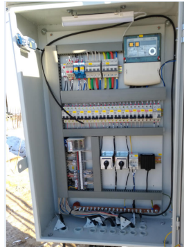
Рис. 6.15. Вид шкафа собственных нужд
